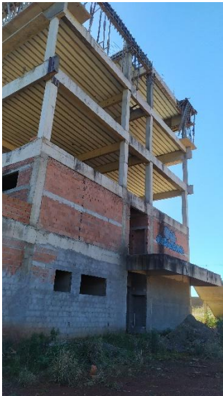
Foto 07 – Desalinhamento entre pilares e vigas (a ser conferido com o projeto estrutural)
