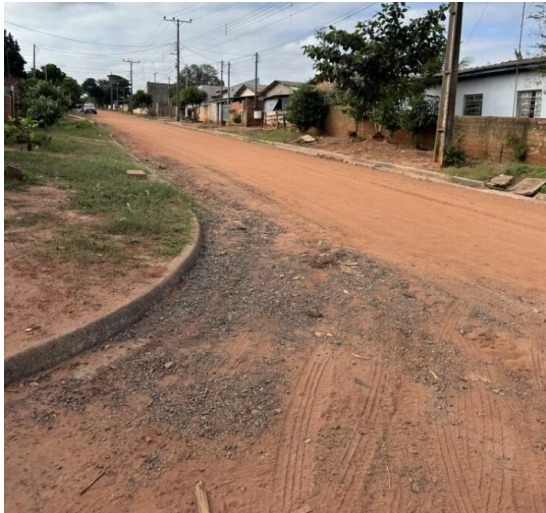
Foto 08 – Deterioração da imprimação.
