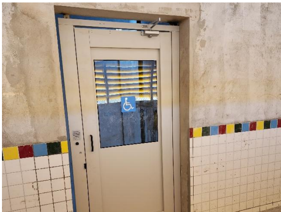
Foto 04 – Elevador PCD instalado.
