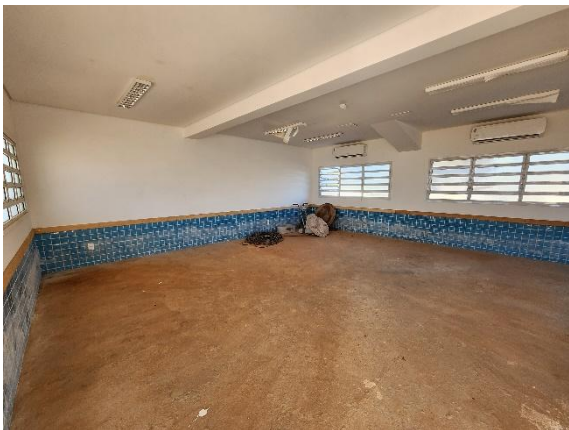
Foto 02 – Sala de aula com aparelhos de ar condicionado.
