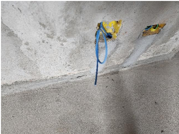
Foto 08 – Cabeamento de lógica e de energia já instalados.
