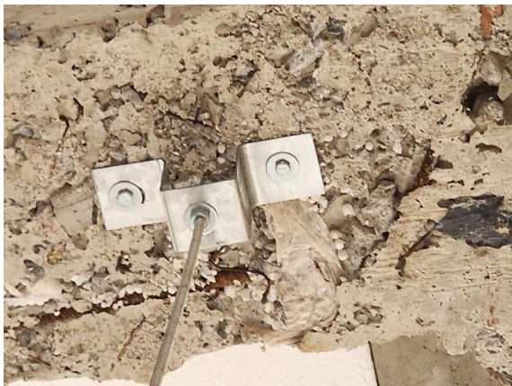
Foto 05 – Bicheira na concretagem.
