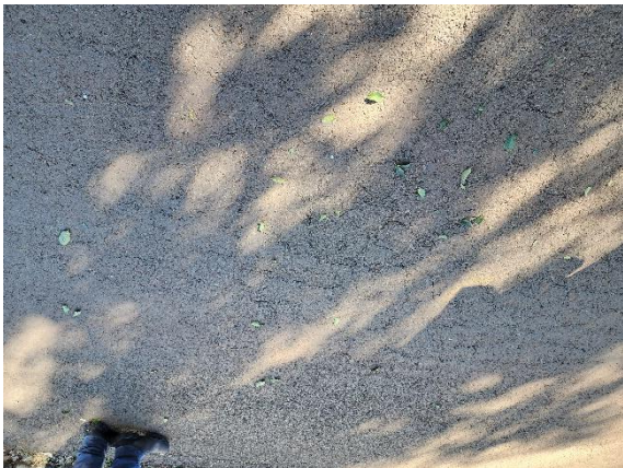
Foto 02 – Trincas no pavimento.
