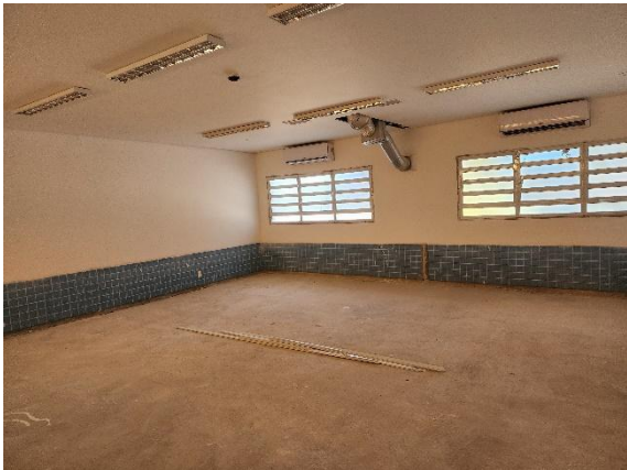
Foto 04 – Sala de aula com aparelhos de ar condicionado.
