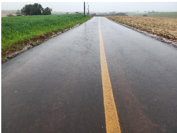
Foto 03 – Irregularidades visíveis no trecho pavimentado.
