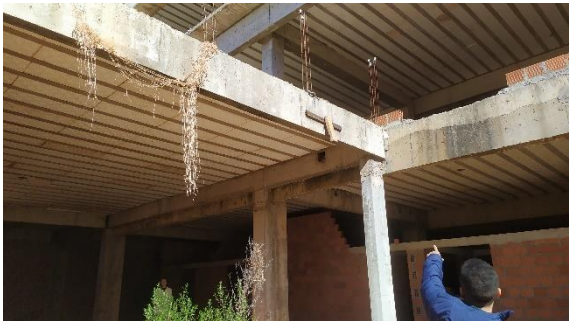
Foto 03 – Junta fria em viga de concreto
