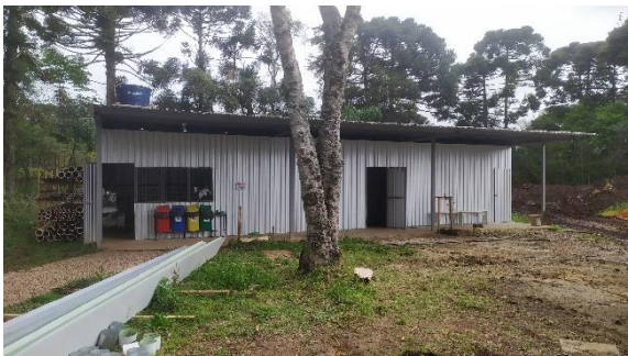
Foto 02 – Refeitório e sanitários da obra
