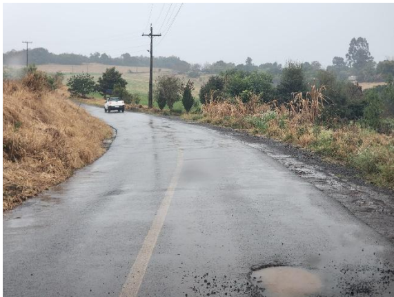
Foto 07 – Buraco na via.
