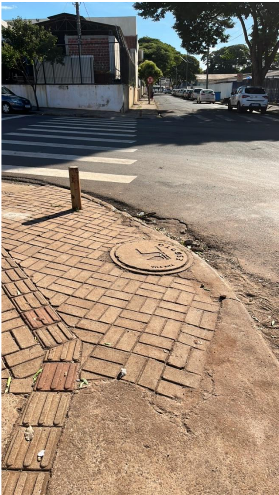
Foto 02 – Poço de Visita
