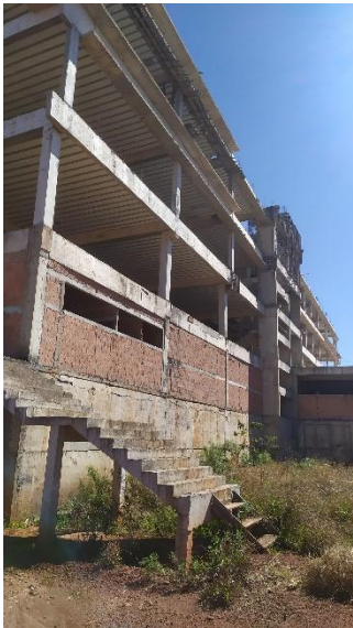
Foto 08 – Desalinhamento entre pilares e vigas (a ser conferido com o projeto estrutural)
