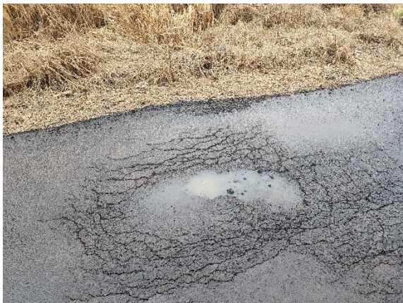
Foto 05 – Afundamento e trincas no trecho pavimentado.
