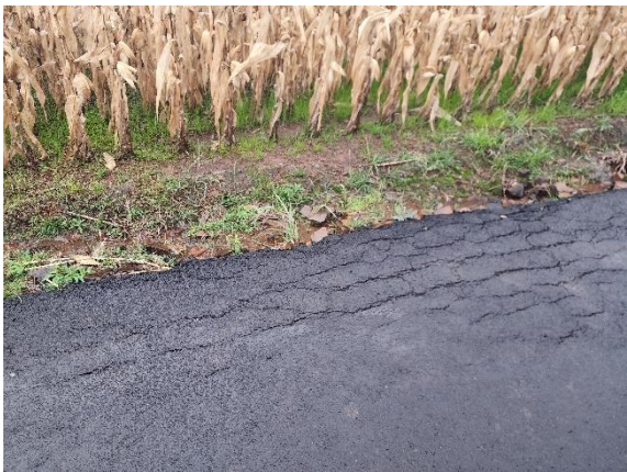
Foto 06 – Trincas nas laterais do pavimento.
