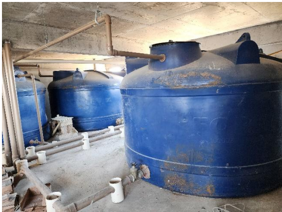
Foto 05 – Caixas d'água da edificação.
