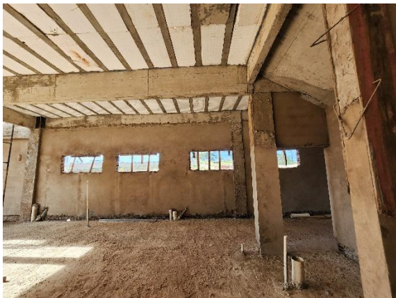
Foto 07 – Pilares fora de prumo.
