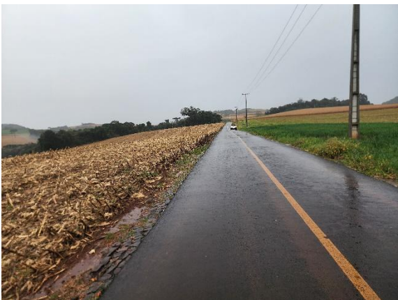
Foto 04 – Trincas visíveis no trecho.
