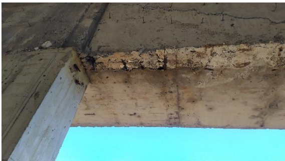
Foto 02 – Armaduras expostas (pilar e viga desalinhados – a ser conferido no projeto estrutural)
