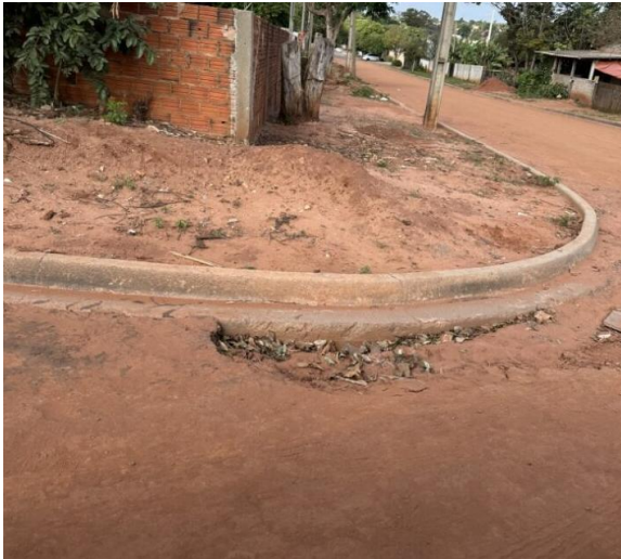
Foto 05 – Deterioração da base.
