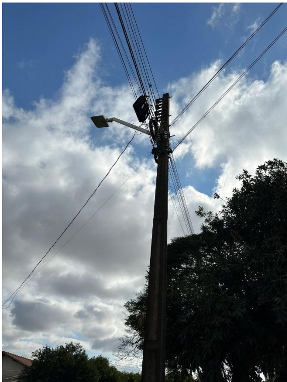
Foto 05 – Iluminação Pública Guairaça
