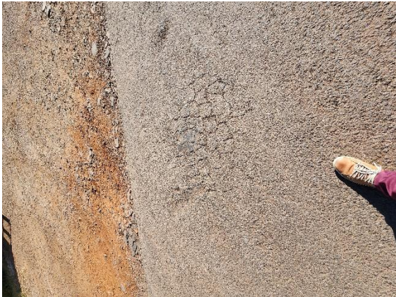
Foto 05 – Trincas no pavimento.
