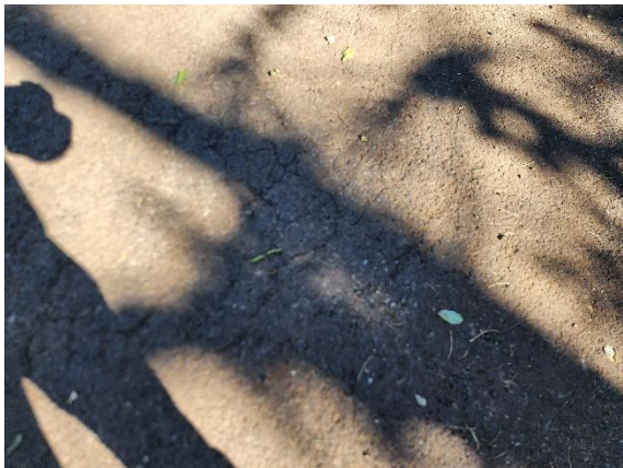
Foto 01 – Trincas no pavimento.
