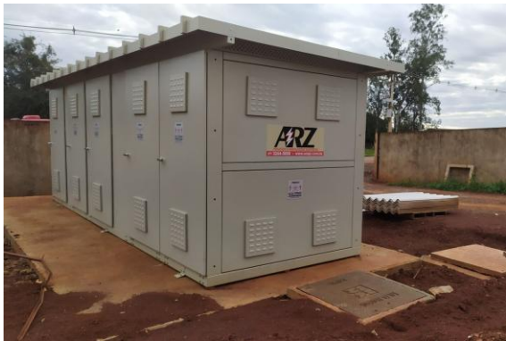
Foto 07 – Entrada de energia.
