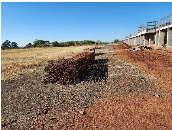
Foto 06 – Ferragens abandonadas no local após interdição.
