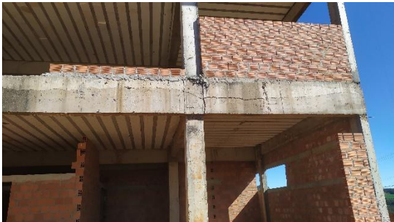
Foto 04 – Junta fria em viga de concreto
