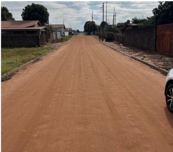
Foto 01 – Pavimento sem a camada de CBUQ.
