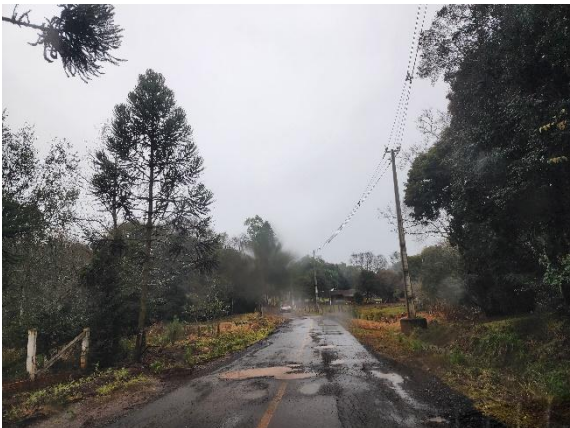
Foto 02 – Trecho danificado após alagamento.
