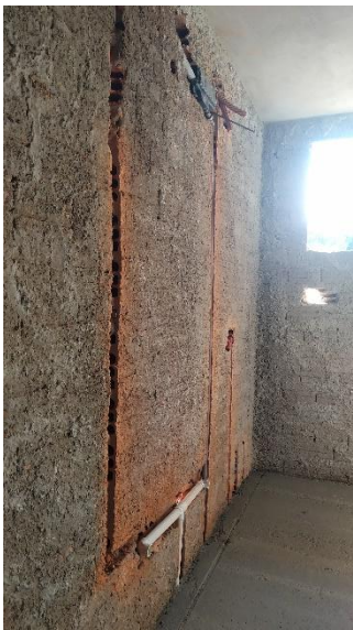
Foto 08 – Instalações elétricas e hidráulicas
