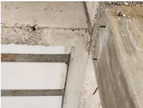
Foto 04 – Bicheira na concretagem.
