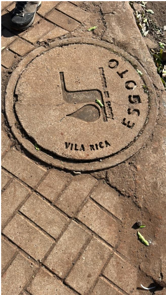
Foto 01 – Poço de Visita
