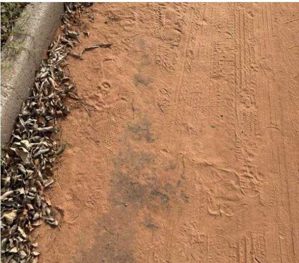
Foto 03 – Deterioração da imprimação
