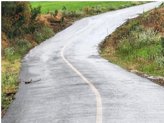
Foto 01 – Irregularidades visíveis no trecho pavimentado.
