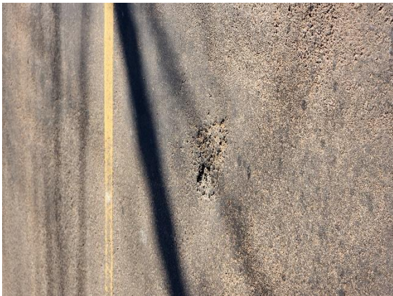
Foto 02 – Defeito no pavimento.
