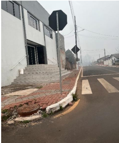
Foto 08 – Rua Cid Damiani: Calçada danificada
