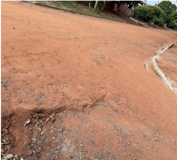
Foto 06 – Deterioração da base.
