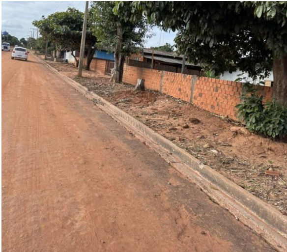
Foto 07 – Deterioração da imprimação.
