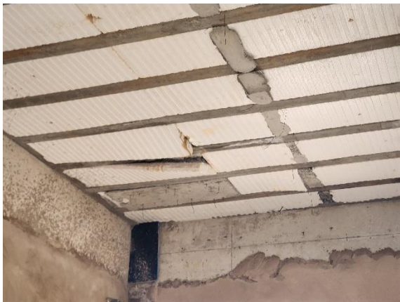
Foto 03 – Problemas na concretagem da laje.
