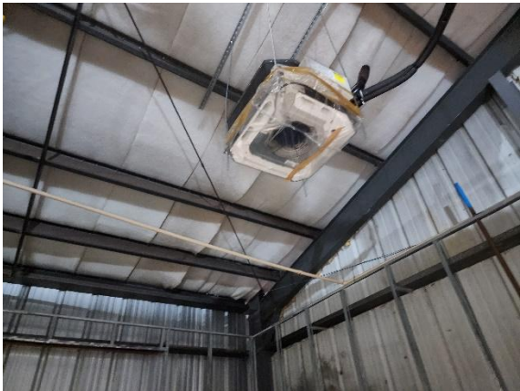
Foto 07 – Aparelho de ar-condicionado já instalado.
