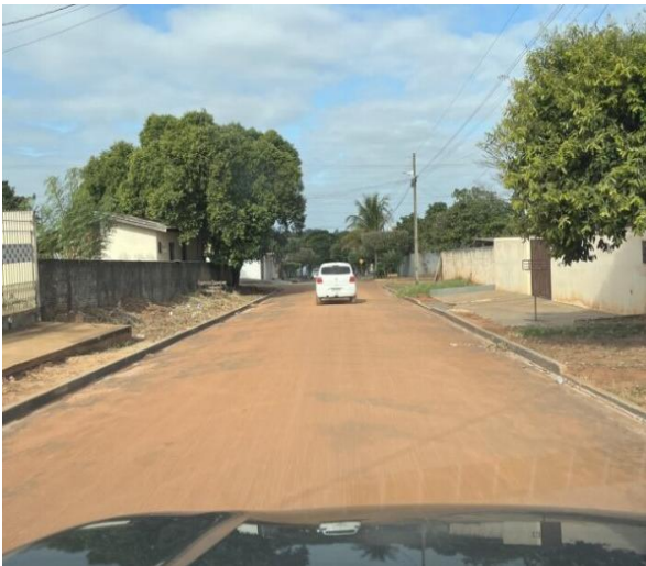
Foto 02 – Pavimento com imprimação deteriorada.
