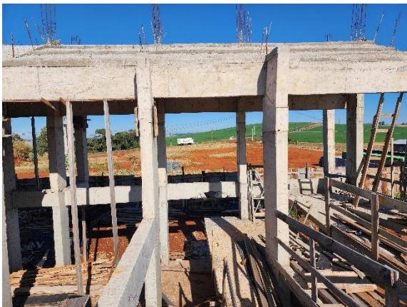
Foto 08 – Serviços a executar e defeitos na execução.
